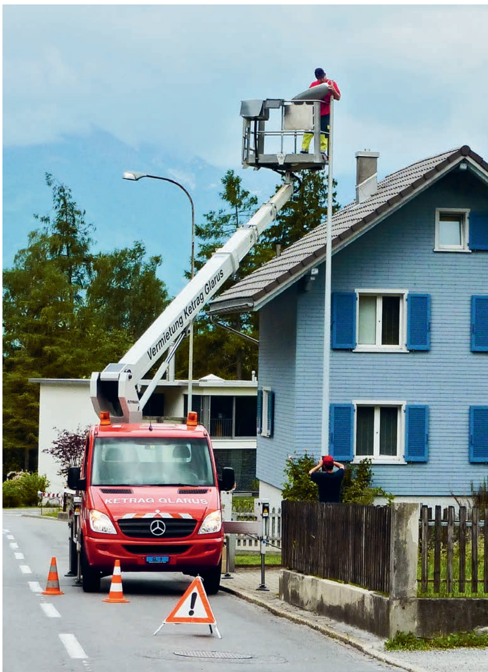
Monteure ersetzen die alten Quecksilberdampflampen in den Glarner Gemeinden durch moderne LED-Leuchten.
