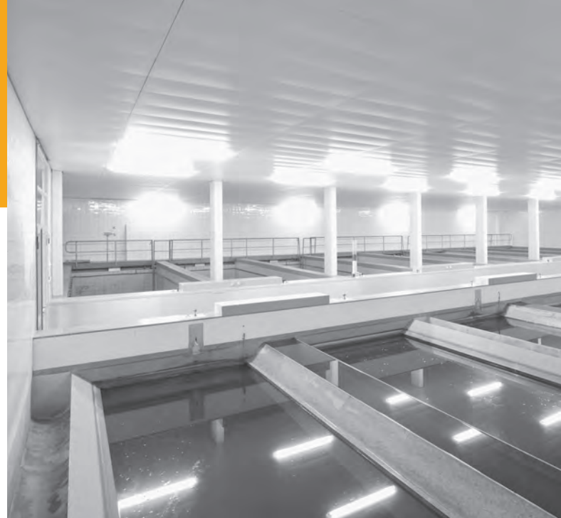
Rohwasserbecken Filterstation Seewasserwerk Rüschlikon
