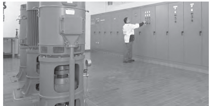
Rohwasserpumpwerk Seestrasse Rüschlikon
