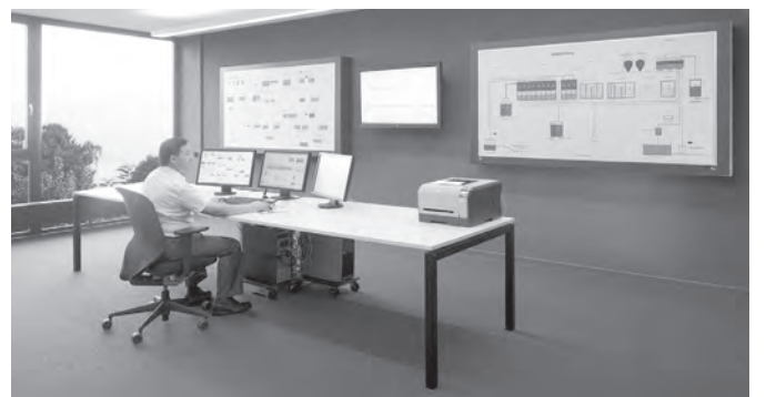
Kommandozone im Seewasserwerk Rüslikon
