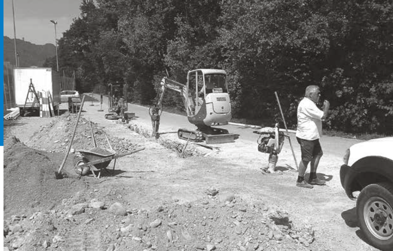
Freiwillige des FCL bauen unter der Anleitung eines Baufachmannes die Zuleitungen zum neuen Clubhaus
